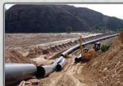
خط انتقال گاز خطر
